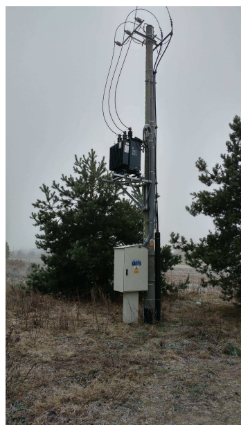
Fot. 1,2,3,4,5. Tereny wzdłuż północnej granicy Planu wzdłuż części drogi o nawierzchni gruntowej (ul. Kucki);
