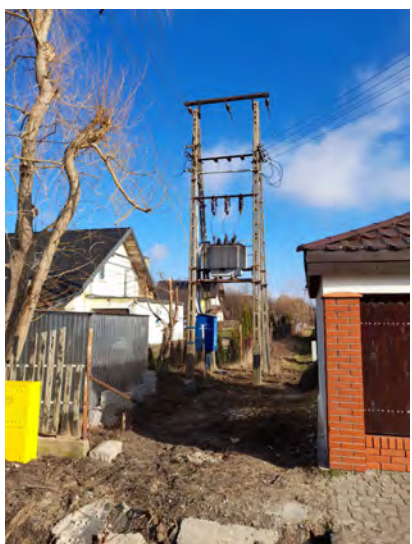
Fot. 40, 41, 42. Tereny infrastruktury technicznej - istniejące stacje trafo (ul. Jesionowa fot. 40 i 41 i ul. Główna fot. 42).
