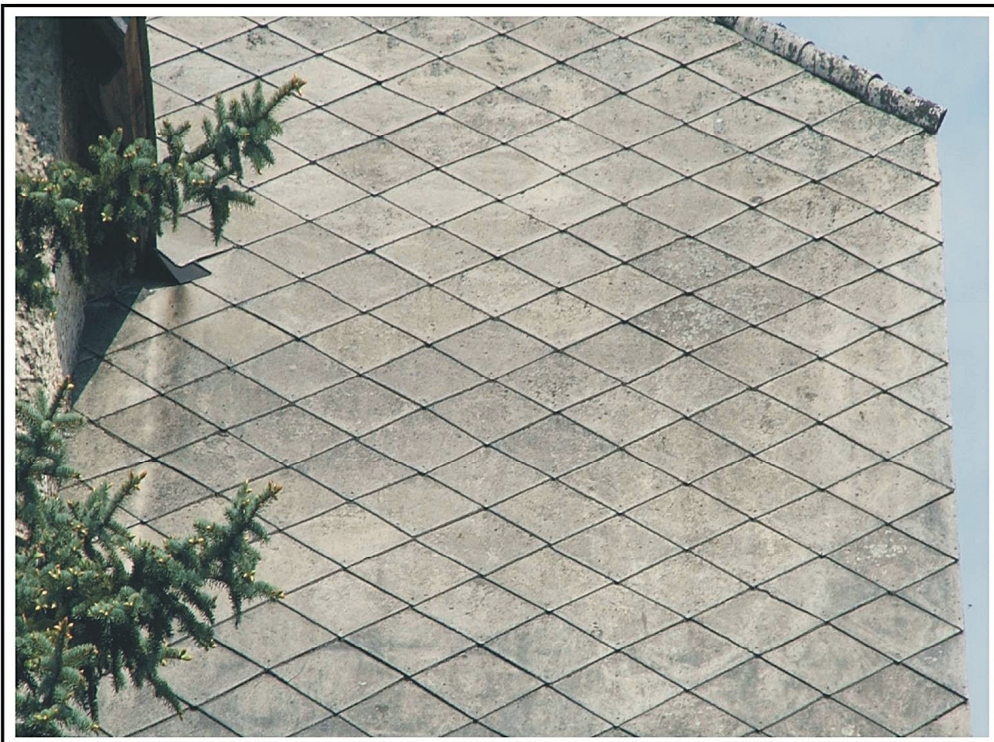
Fot.4 Pokrycie dachowe budynku mieszkalnego z płytek typu "caro" - III stopień pilności
